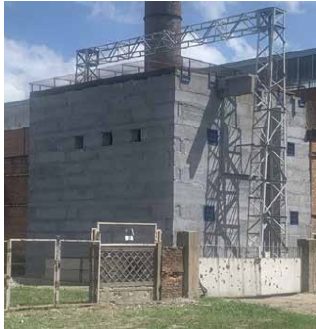
Рисунок 1 – Бетонне укриття трансформатора
